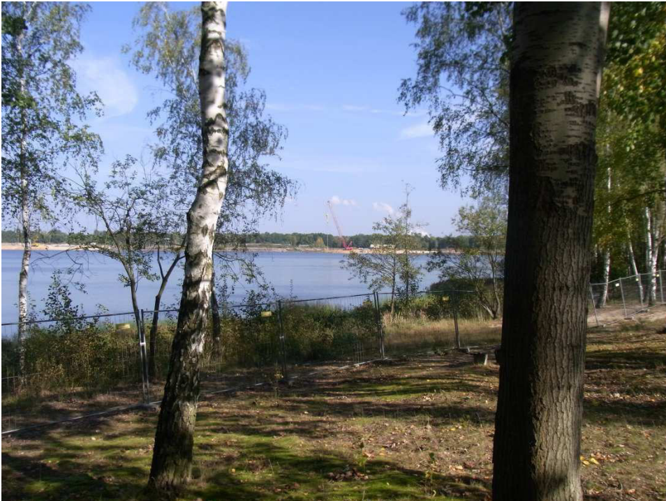
Nachsanierung des gesamten TRS mittels Rüttelstopfverdichtung durch die Fa. Keller Grundbau GmbH Ort: Silbersee/Tgb. Werminghoff II/Lohsa 1/Sachsen; Quelle: Copyright: M. Lersow; Tag der Aufnahme: 12.10.2012
